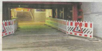
Die Gleise sind aktuell nur über Treppen zu erreichen, Aufzüge gibt es nicht.
